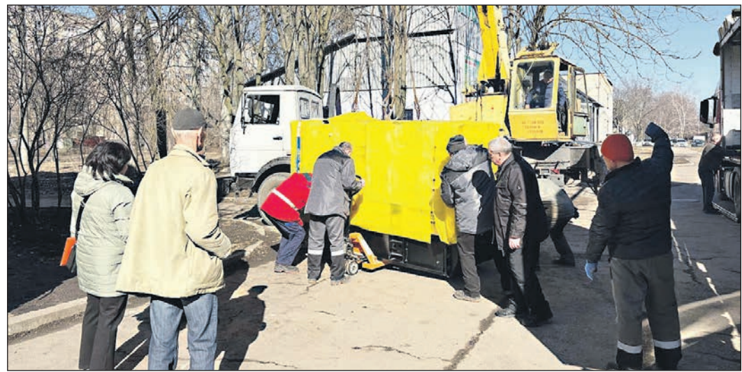
Nach der Fahrt quer durch Europa und der Ankunft in Zhovti Vody wird der Notstromgenerator sorgsam vom Lkw entladen. Foto: privat
